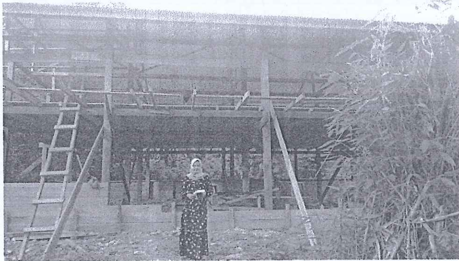
Foto peneliti mengamati pekerjaan Bangunan yang akan di bangun dari Anggaran Dana Gampong di Gampong Sekualan
